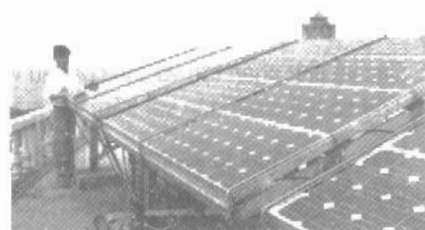
Hình 56.3 Pin mặt trời trên dach Bạch Long Vĩ
