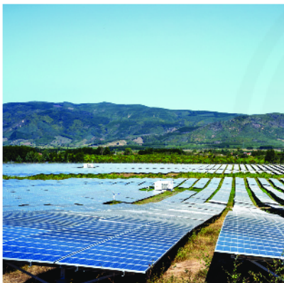
a) Trạm phát điện Khánh Hoà
