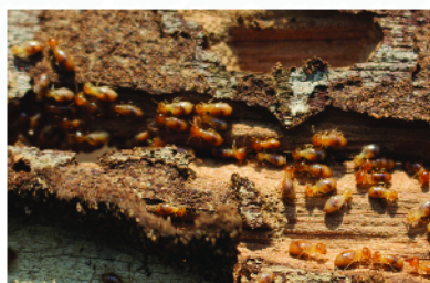
Mối phá hoại công trình xây dựng
